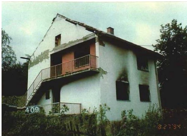
Оштећена кућа Тривка Жугића
